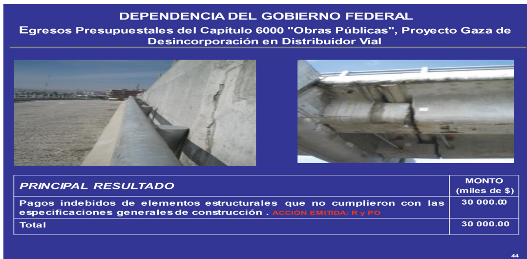
Gráfica 8. Fallas constructivas que impiden cumplir la calidad estructural necesaria
